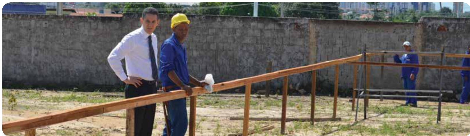
Presidente da AMMA, Gervásio Santos, visita obras de construção do salão de festas que tem previsão para ser concluída no final deste ano
