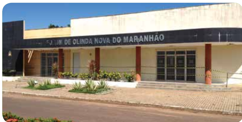
Fórum de Olinda Nova apresenta graves problemas estruturais
